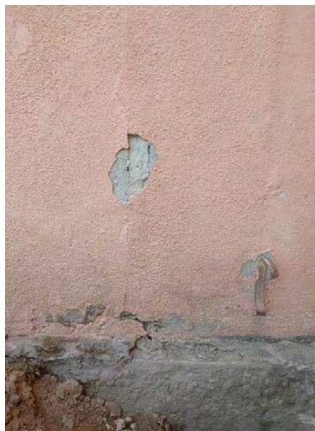
Fig. 5. Exfolieri ale tencuiei exterioare
