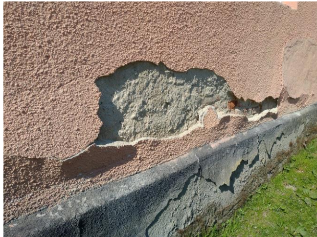
Fig. 4. Exfolieri ale tencuiei exterioare
